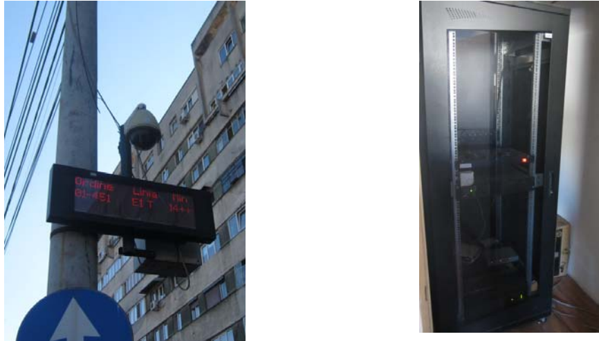
Figura 52: CCTV pentru supravegherea stațiilor de transport public. Server-ul din dispeceratul RAT (fotografie din arhiva proprie)
