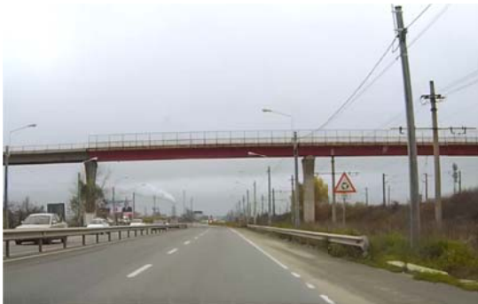
Figura 25: Dispozitiv de protecție periculos, Craiova, Calea Severinului
