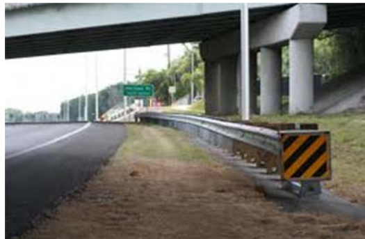
Figura 26: Dispozitive de protecție corespunzătoare (Sursă: Manual de siguranță rutieră pentru Rep. Moldova. Administrația de Stat a Drumurilor, 2011)
