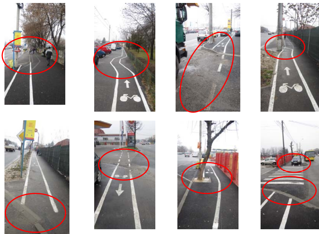
Figura 36: Exemple cu deficiențe majore semnalate pe traseele pistelor de biciclete de pe strada Caracal (fotografii din arhiva proprie)
