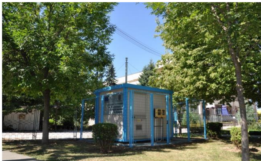
Figura 2-25 Stația automată de monitorizare a calității aerului Billa DJ3
