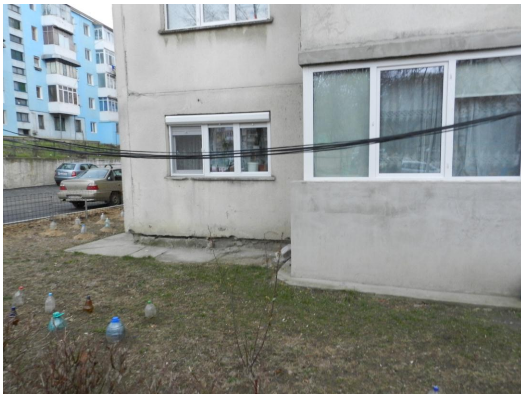
Foto.2 Trotuar tasat si degradat
