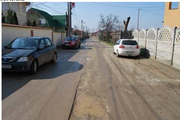
Foto 74.1 Suprastructura afectata de lucrări de canalizare/rețea subterană
