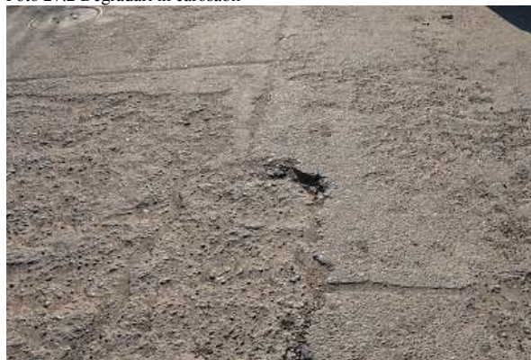
Foto 27.2 Degradări în carosabil
