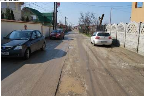
Foto 74.1 Suprastructura afectata de lucrări de canalizare/rețea subterană
